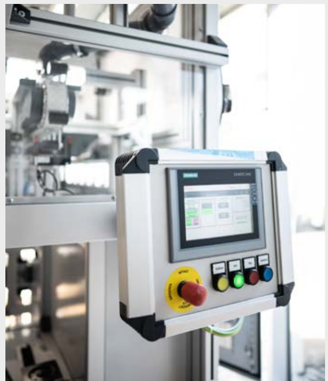
Steuerungs-Panel der Anlage.
